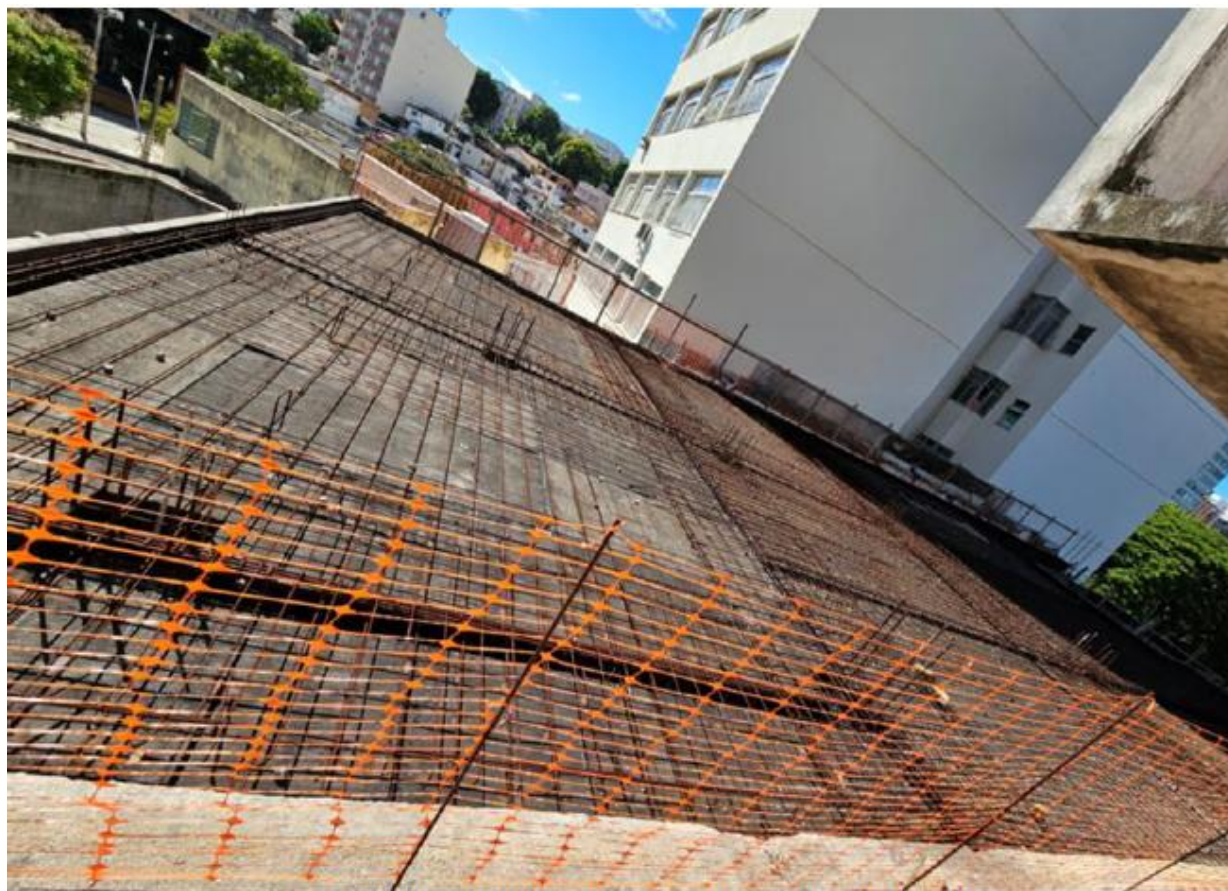
Foto 16: Laje com armadura exposta em obra paralisada.
