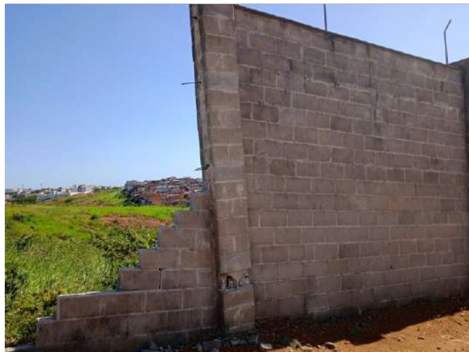
Foto 14 – Vista do muro caído (lateral direita)
