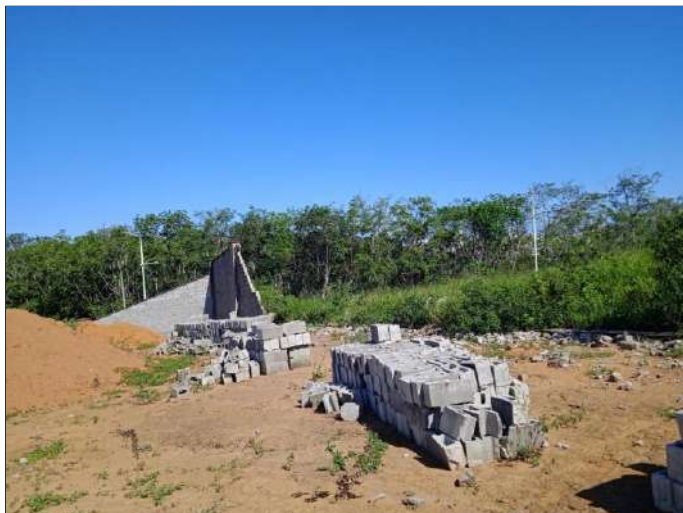
Foto 13 – Vista do muro caído (junto à frente)
