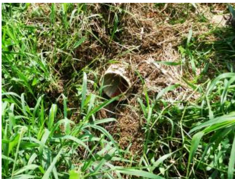
Figura 8: Tubulação para despejo de efluentes na área 2.
